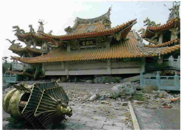
写真 4 地震動で1階部分が潰された寺院（集集）.
