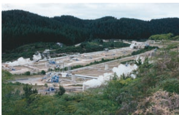
図 3 ワイラケイ地熱発電所。近くの井戸からパイプで蒸気・熱水が運ばれている。水冷式でクーリングタワーが見られない。
