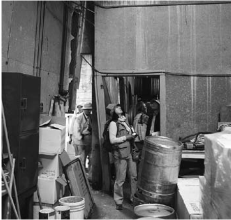
図 8 デローズワイナリを引き裂くサンアンドレアス断層のクリープ。中央の人物背後の壁の手前直下にある断層の動きにより、壁は南南東へ、壁の左の右に傾く柱は北北西へ動いている。壁と柱は天井ではまだつながっている（9日目）。
